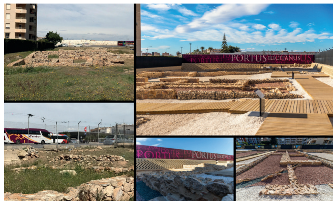
Figura 5. La parcela Portus antes y después de la intervención del «Proyecto FEDER Puesta en Valor del Portus Illicitanus».
