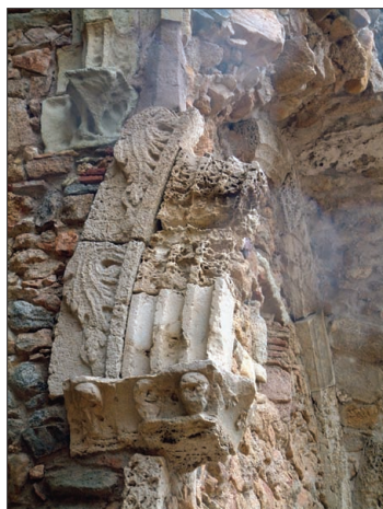
Fig. 25. Pérdida de materia en las figuras de la base.
