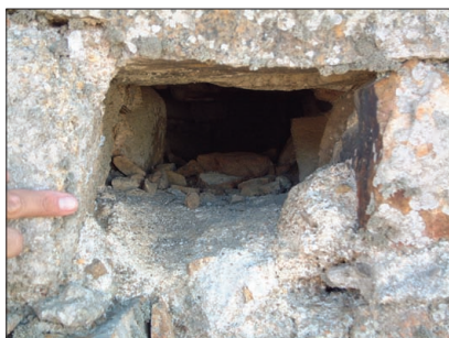
Fig. 22. Eflorescencias formadas a partir de los morteros de junta.
