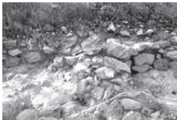
Figura 6. Spostamento centrale del muretto a S.
