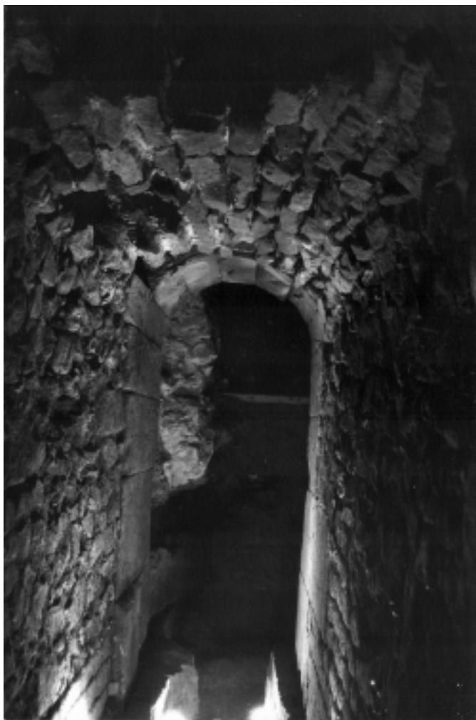
Figura 16 Secció interior de la conducció del carrer de la Palma de Sant Just. (Fotografia: Centre de Documentació-MUHBA)
