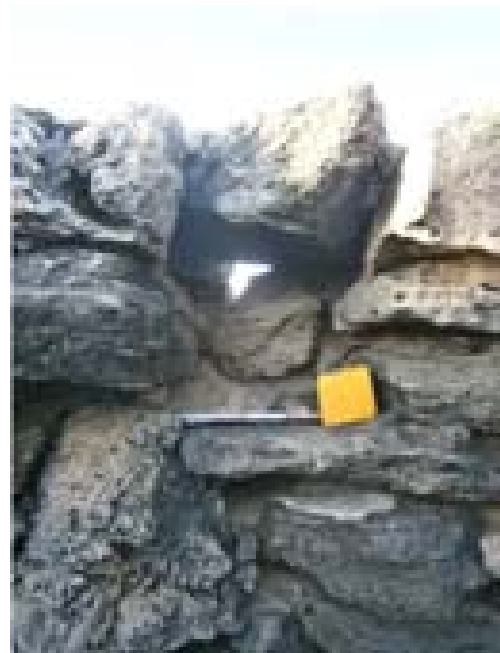
FOTO 422. Excavació i documentació: T3. Estat previ amb la finestra tapiada, per l'interior.
