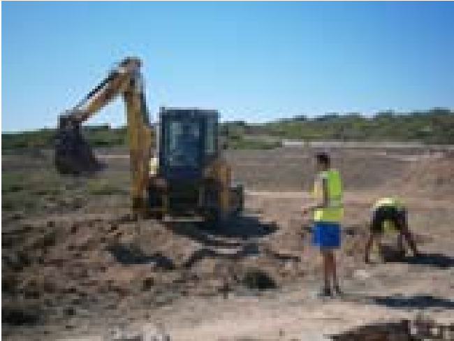
FOTO 41. Feines realitzades: control de la retroexcavadora i recuperació de blocs de la terrera del sector sud-est del jaciment.
