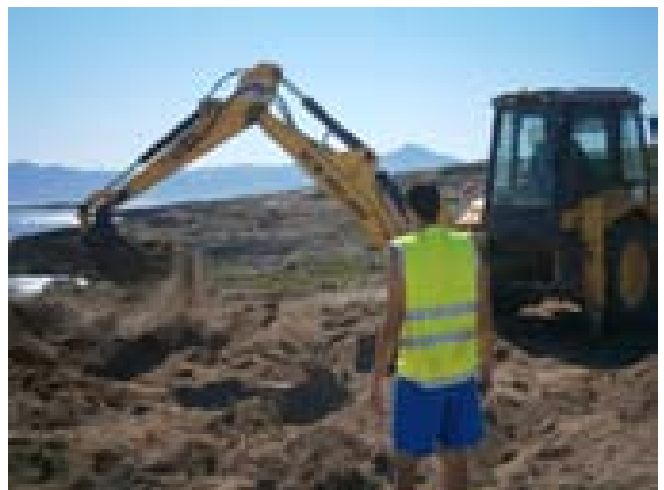
FOTO 40. Feines realitzades: control de la retroexcavadora durant l'eliminació de la terrera del sector sud-est del jaciment.
