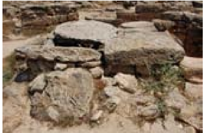
FOTO 438. Vista de T57 des del seu costat est. Abans de la intervenció.
