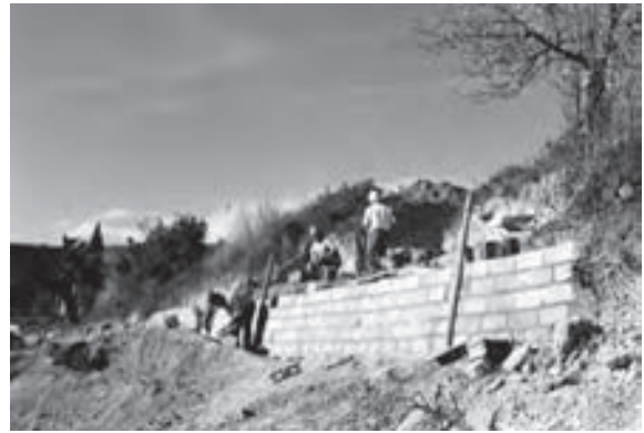
Figura 13. Vista del conjunt termal, un cop construït el muret de protecció, el març de 1984.
